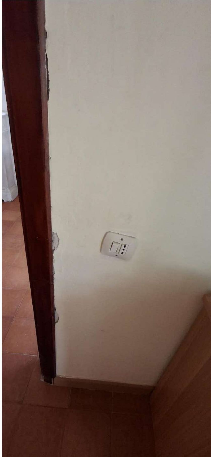
Foto 10: dettaglio porte interne e pulsanti impianto luce
